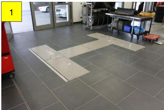
1 Hebebühne mit vollständig bodenebenem Klappdeckelrahmen.
